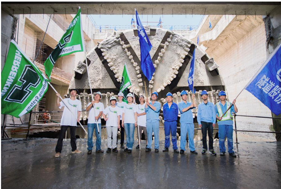
Bild 3: Durchbruch am 19. Juni 2013: Die S-569 ( \varnothing 15.430 mm) hat erfolgreich den West Changjiang Road River Tunnel aufgeföhren.
